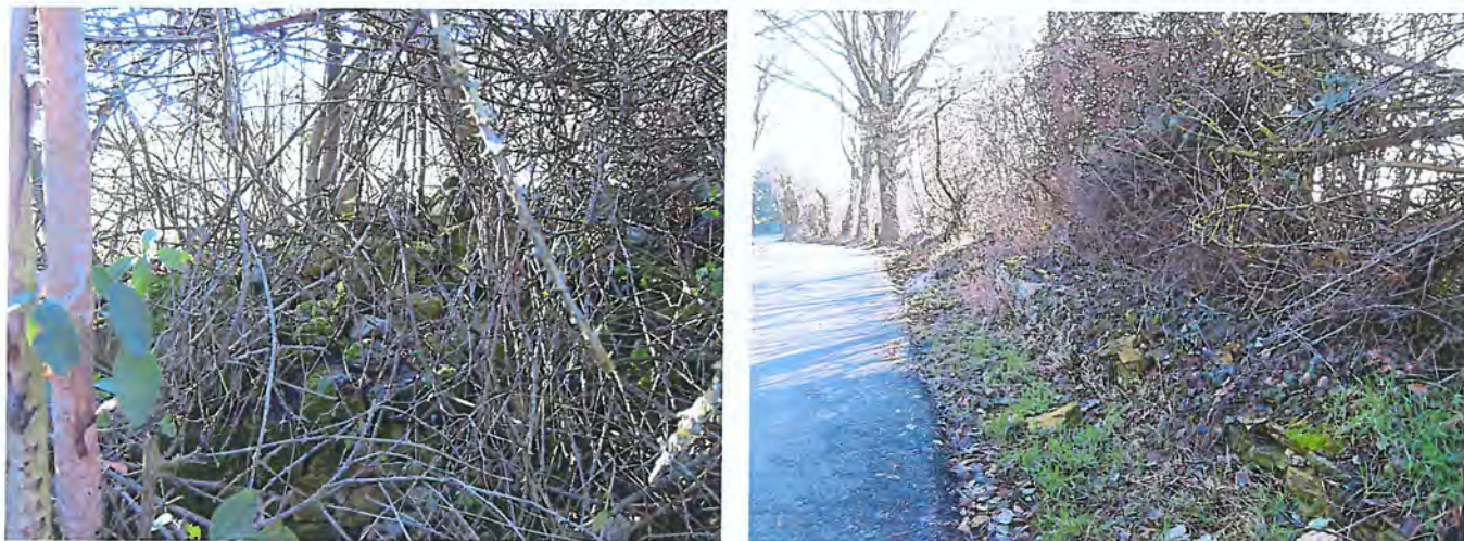
Figure 3 : Mur 2, effondré, situé dans la haie 1
